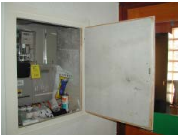
Caisse de sécurité avec plaque de protection antifeu contenant de l'amiante à l'intérieur de la porte, photo: JMF/SLE, IST
