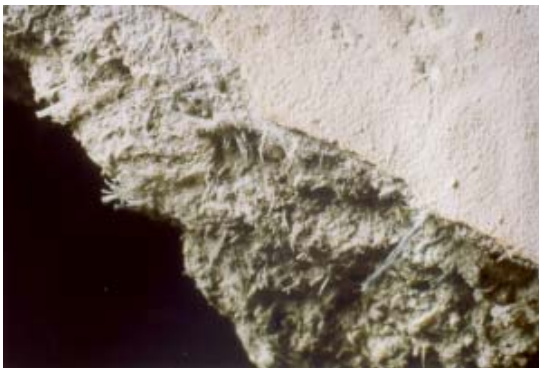
Plaque de fibrociment brisée avec des faisceaux de fibres, photo: SA
